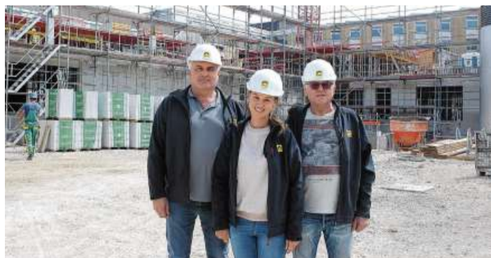
Das Bauleiterteam der Rohbaufirma Baresel kümmert sich täglich um alle Belange des Neubaus, von links: Josef Engelmann, Elin Tichy und Andreas Haubold.
