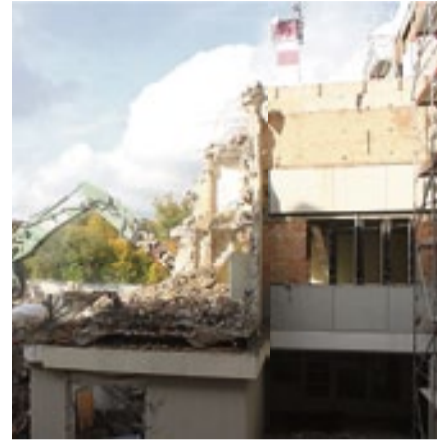
Ende Oktober standen nur noch wenige Fragmente des einst vierstöckigen Erweiterungsbaus mit Teilunterkellerung.
